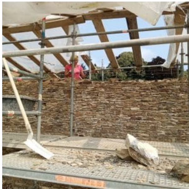
Anna et maxime on presque fini de placer les pierres une par une, avec du sable et de la chaux. A l'ancienne, c'est un travail de passionnés. C'est normal, le château est un monument historique.
